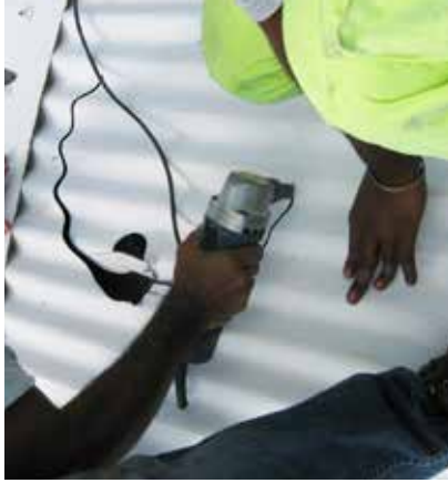
Découpe gabarit à la grignotteuse (évite la dépose de limaille qui endommage les toitures en rouillant)
