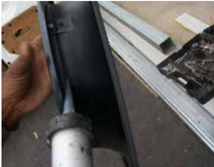
4 Mise en place de colle mastic au niveau de la jupe anti-retour
