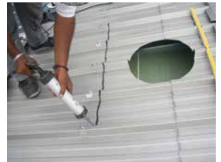
9 Mise en place d'un closoir en partie basse et haute du trou et fixation avec de la colle mastic
